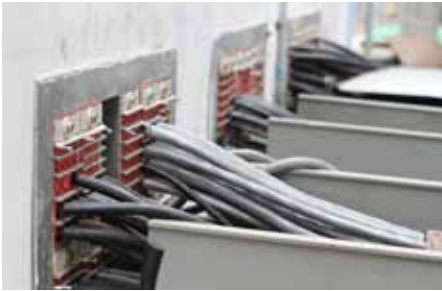
电缆进入设备盘柜封堵
